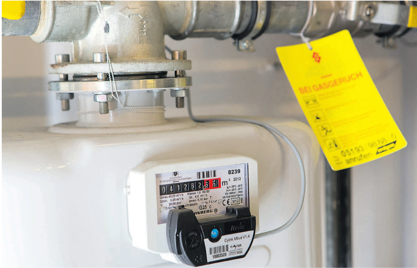
Ein Gaszähler einer Gastherme: Ab 2024 sollen laut Entwürfen der Bundesregierung keine neuen Erdgas- und Ölheizungen mehr eingebaut werden. Von der FDP kommt scharfe Kritik. DPA-BILD: JÖRG SARBACH
